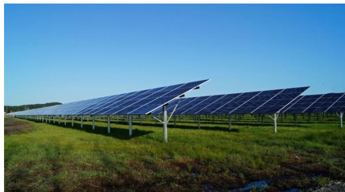
設置したソーラーパネルの一部
