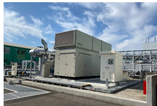
鳴門工場のコージェネレーションシステム
